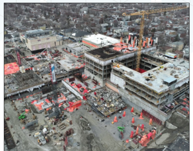
Le chantier de la phase 1 avance à grands pas. Sur la photo, on aperçoit à gauche le stationnement souterrain et, à droite, le Centre intégré de cancérologie.
