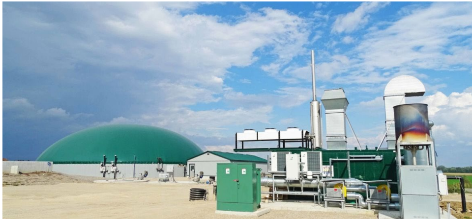
Figure 10 : Photo d'une installation de DLS Biogas
