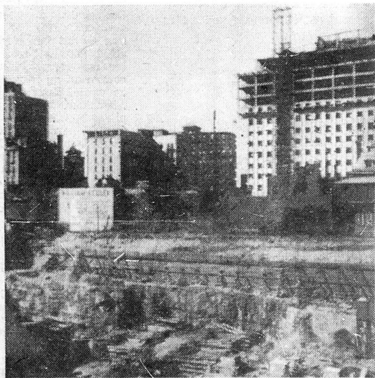
Face à l'hôtel Reine Elizabeth, la fosse gigantesque des fondations de la future place Ville-Marie.
