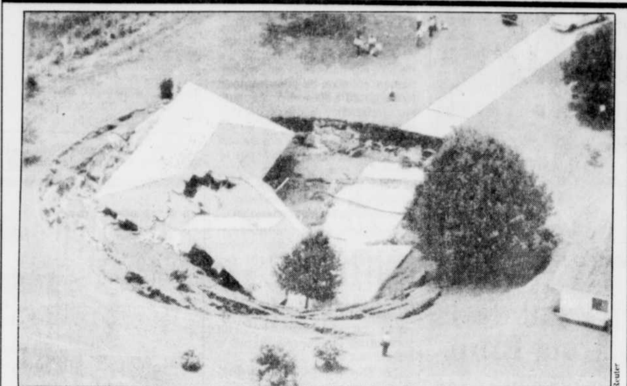
Affaissement de terrain
