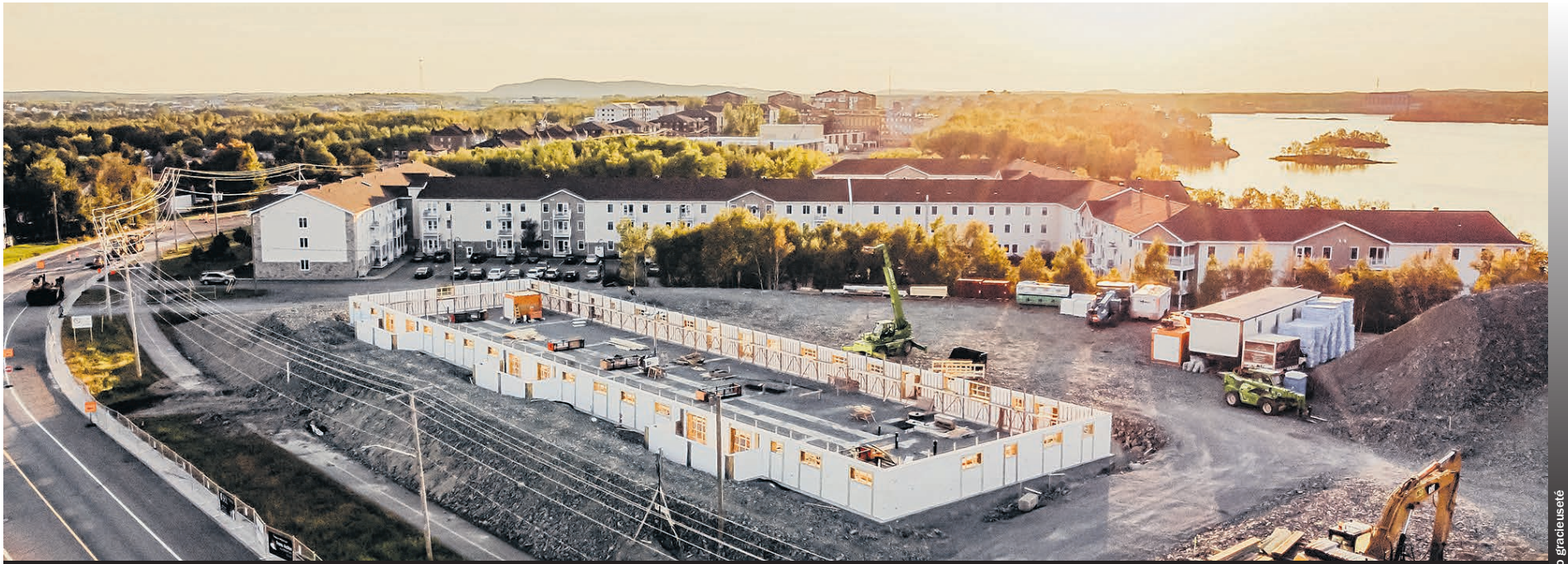
Le chantier est déjà bien avancé sur la Perreault Est à Rouyn-Noranda tout près des Jardins du Patrimoine.
