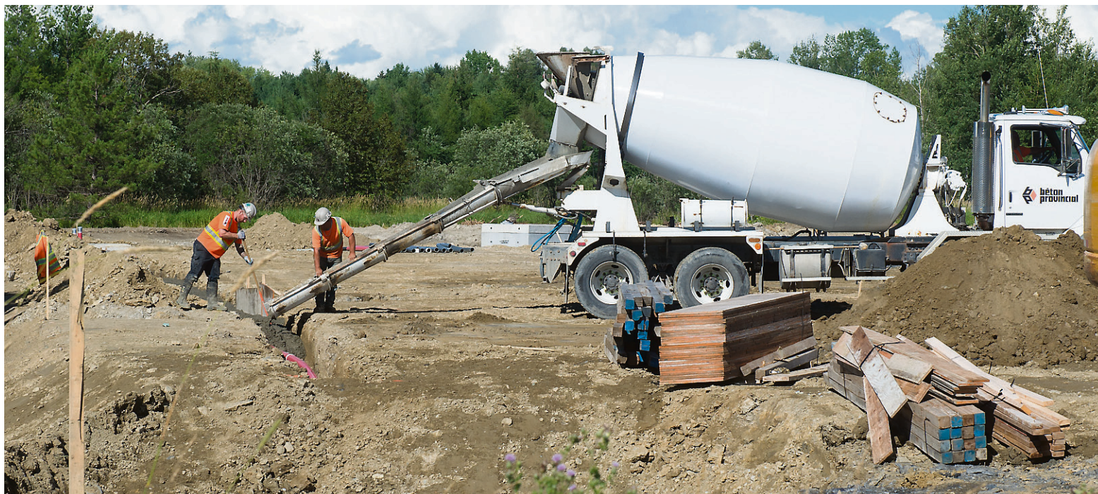
La construction d'un troisième bâtiment a été lancée dans le parc Innovation, en face de l'école secondaire du Triolet. Le futur bâtiment abritera les travaux de la Chaire de recherche en éthanol cellulosique et sur les biocommodités, de même que des chercheurs du Centre de recherche sur les infrastructures en béton et du Centre de recherche en génie parasismique (CRGP). — PHOTO SPECTRE MÉDIA, JULIEN CHAMBERLAND
