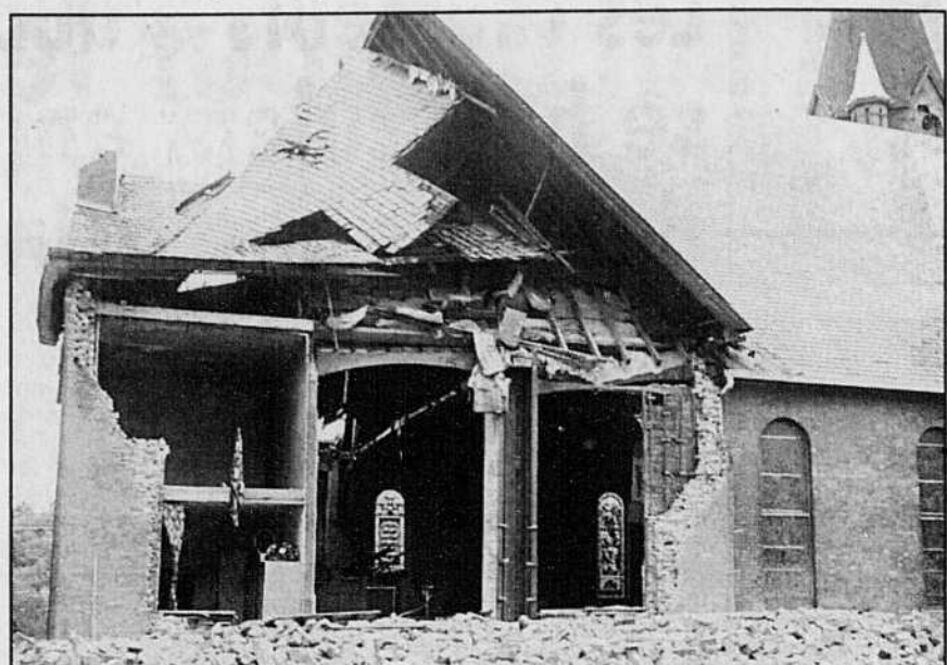
Des structures de briques comme l'église St-Andrews, rue Frontenac, ont été éventrées.
