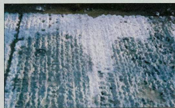
Texture de surface obtenue par hydro-démolition et aperçu des dommages causés de part et d'autre par l'appareil
