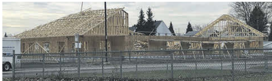
Les fermes de toit du CPE en construction près du parc Dorimène-Desjardins se sont effondrées, mais personne n'a été blessé. Photo gracieuseté
