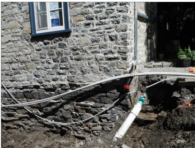
Photo 8 Sous le drain, fondation VDQ1607-2A1 dans le prolongement du mur ouest du 9, rue Monseigneur-De Laval, vue vers l'est (VDQ1607-NUM2-75)
