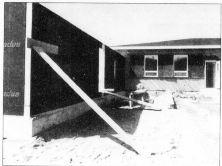
UN PROBLEME - Avec les maisons de plus en plus étanches, la prolifération des appareils de combustion de toutes sortes, les hydrocarbures que l'on retrouve dans l'ameublement, les gaz s'échappent et s'accumulent dans des endroits plus ou moins aérés», indique M. Jacques Denault, directeur du Service de protection contre le feu de Sherbrooke.
