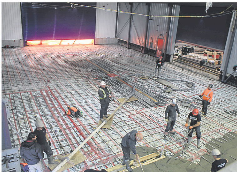
La dalle de béton de la nouvelle aile de Conception navale FMP a été coulée le 18 décembre. Elle sera prête à accueillir les équipements et les bateaux à construire au cours des premières semaines de 2020.
