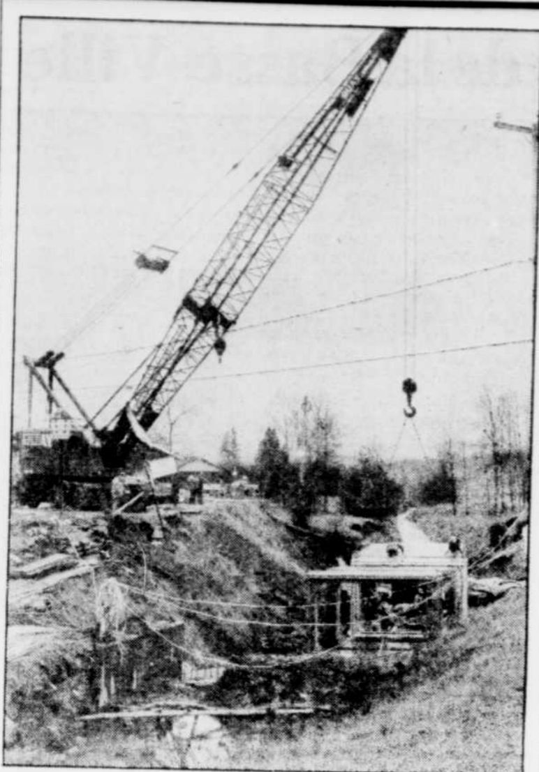
Le pont en reconstruction sur la route 269 à Saint-Jacques-de-Leeds sera ouvert à la circulation dans deux semaines.
