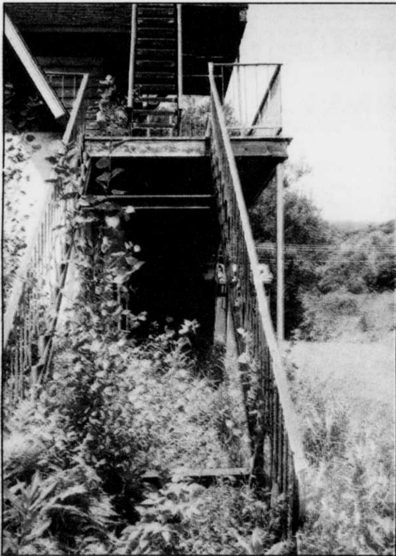
Un escalier rouillé, dont les marches ont été enlevées, mène au second étage du chalet... barricadé, il va s'en dire.
