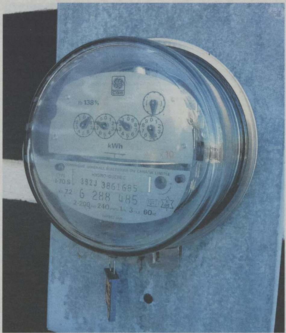
Les compteurs à disque et à cadrans auront disparu du paysage québécois d'ici quatre ans.
