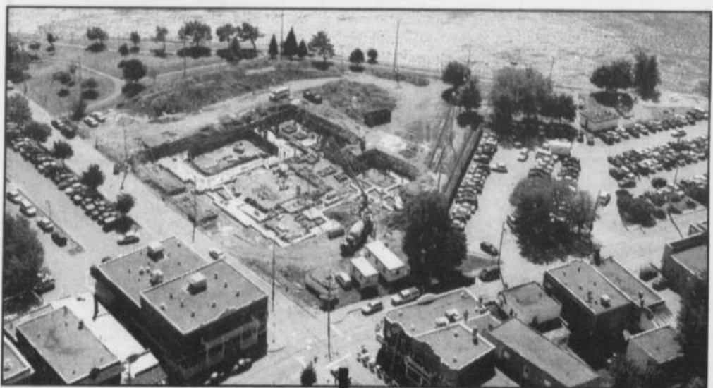
Un réaménagement complet a été commandé par le conseil municipal pour les terrains qui entourent l'immeuble du nouveau Théâtre du Vieux-Terrebonne. Notre photo montre les travaux du théâtre en septembre 2003. (Photo aérienne de Point du Jour Aviation, aéroport de Mascouche)
