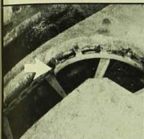
Sabot d'angle de retour du nettoyeur de rigole non protégé, non recouvert.
