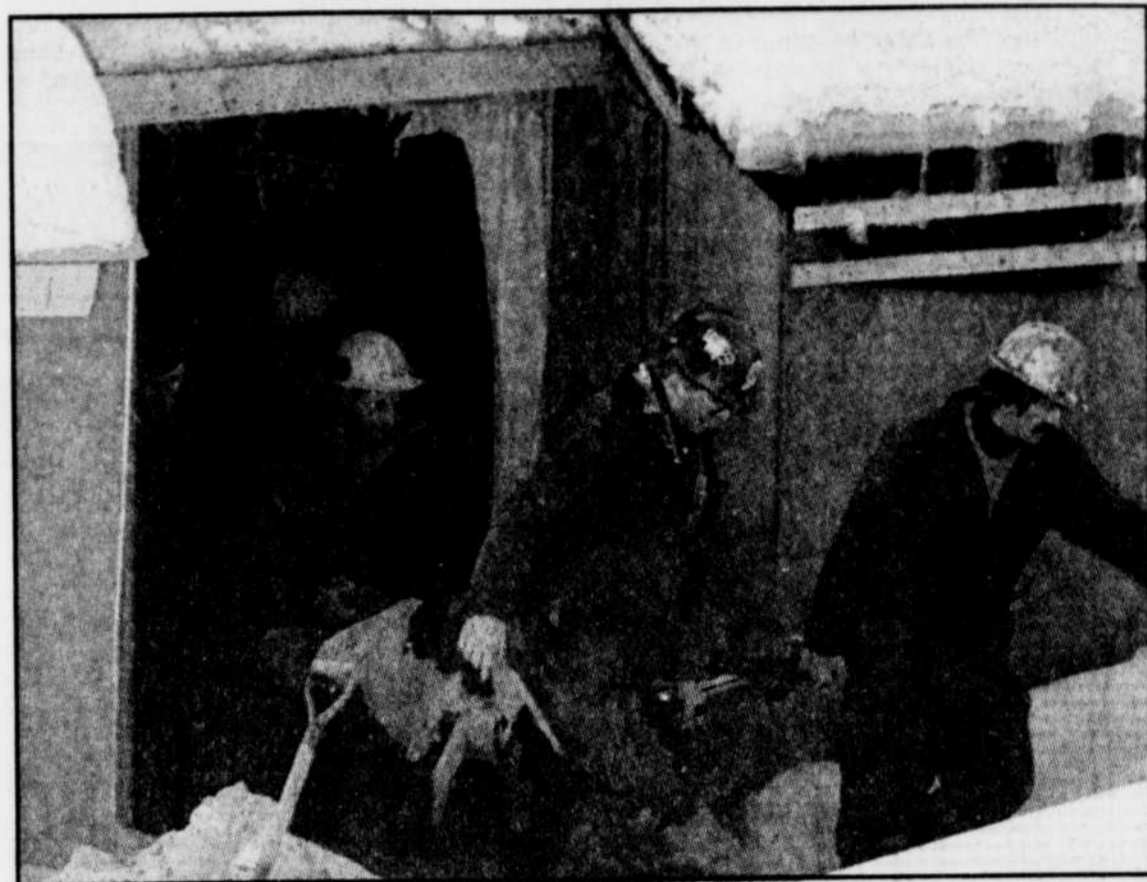
Des travailleurs de la société Torno Québec sortent de l'entrée du tunnel sous-fluvial d'Hydro-Québec le corps de l'une des deux victimes de l'accident survenu hier matin, à Lotbinière.
