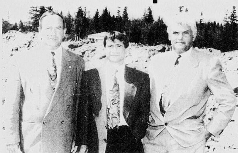
CONSTRUCTION - Bertrand Gagnon, maire suppléant, Alain Lalumière, surintendant des eaux à Jonquière, et Jean Halley, préfet de la MRC du Fjord, face aux excavations destinées à la canalisation d'eau du système de traitement des boues de fosse septique.
