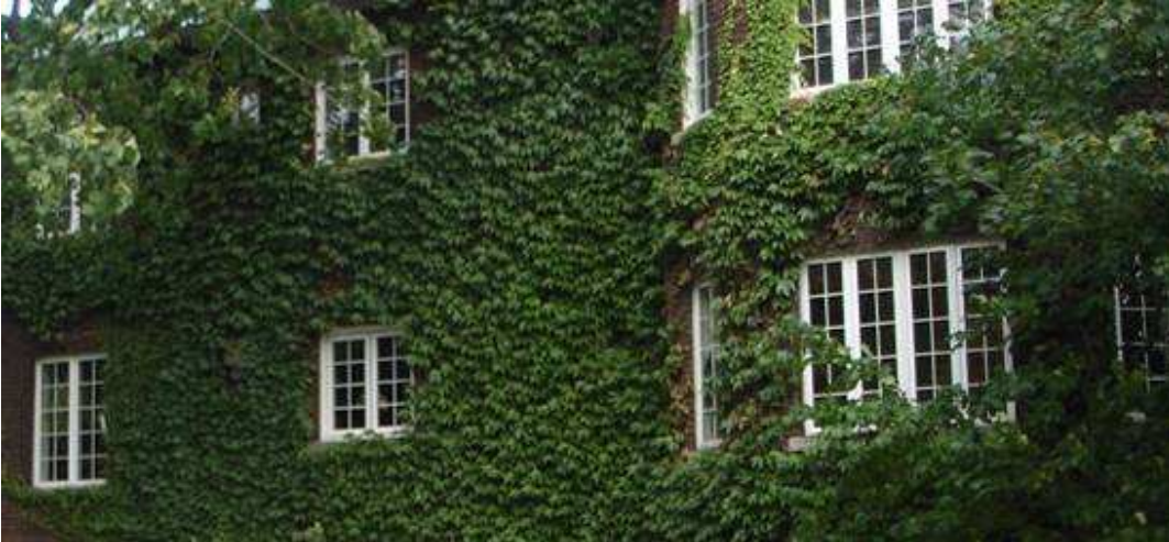
Figure 32. Exemple de mur couvert de lierre
