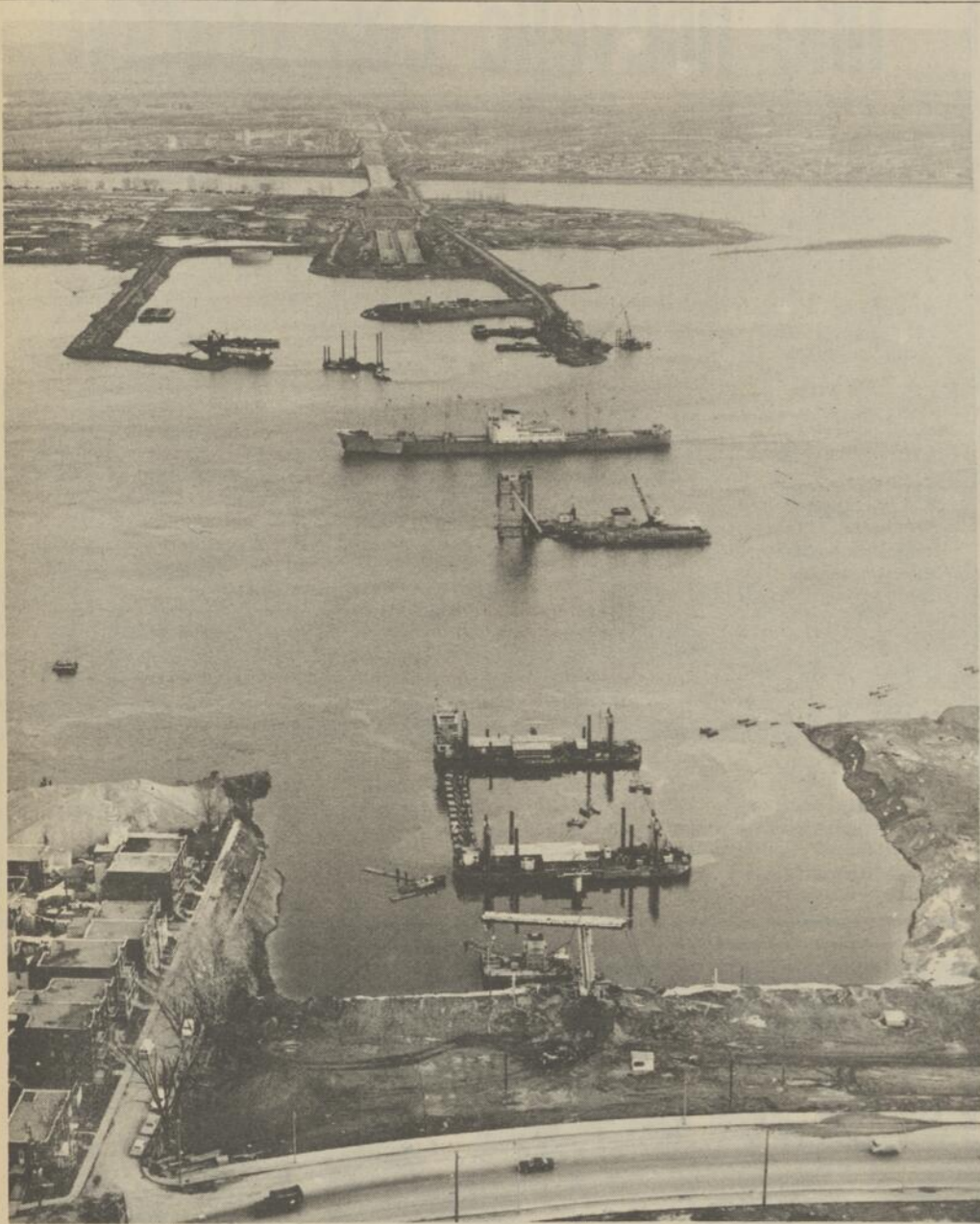
L'ECHOUEMENT, en pleine action, du septième et dernier élément du pont-tunnel Louis-Hippolyte-Lafontaine près de la rive-nord du Saint-Laurent. Au moment où cette photo a été prise, l'élément n'avait pas encore atteint sa position définitive dans la tranchée. On remarquera, aux deux extrémités de cet étrange appareil, les deux cheminées qui, fixées sur le toit de l'élément, servaient de points de repère aux arpentiers pour l'alignement préliminaire avec l'ensemble du tunnel déjà submergé. Ces cheminées donnaient également accès à l'intérieur de l'élément.
