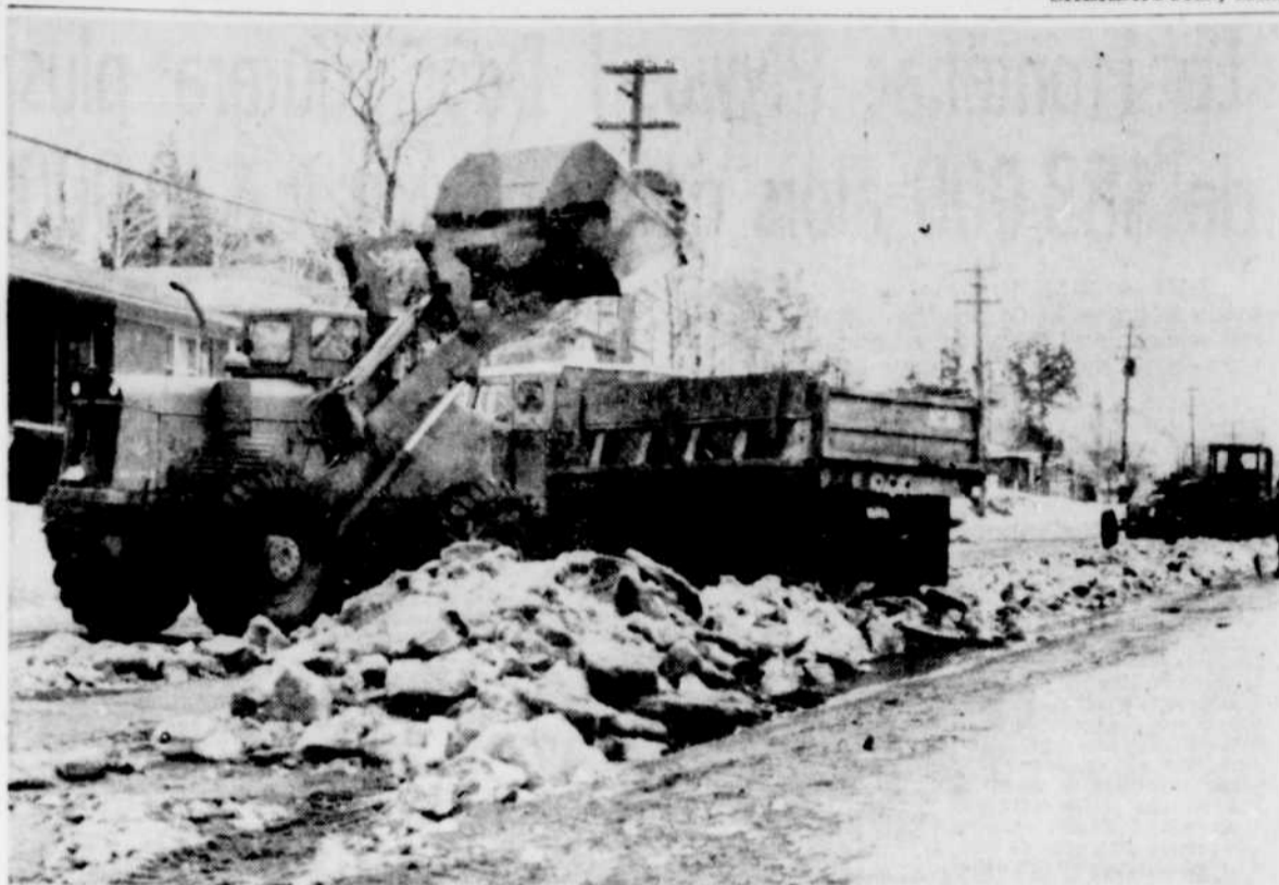
SIGNES AVANT-COUREURS — En attendant la sortie de la marmotte qui est censée annoncer la venue du printemps, la voirie municipale de Sherbrooke a entrepris d'enlever la couche de glace qui recouvre certaines rues de la ville. Ci-haut, on voit le travail qui est effectué rue White. (Photo La Tribune, par Studio Breton)
