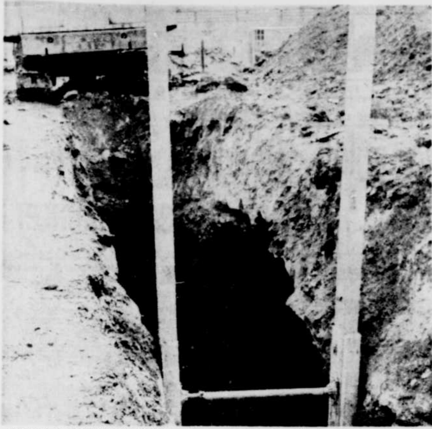
EBOULIS DANS UNE TRANCHEE — Un employé de la ville de Windsor s'est fait fracturer un bras dans un éboulement qui est survenu hier matin dans une tranchée de la rue Principale nord. M. Ronald Roberge travaillait dans le fond d'une tranchée de quelque 12 pieds de profondeur lorsque le terrain a glissé sur lui depuis trois ou quatre pieds à partir de la surface. Cette photo donne une idée de la profondeur de la tranchée. La partie plus pâle de la tranchée, à droite, délimite l'endroit où le terrain a commencé sa glissade sur M. Roberge. On dit que s'il s'était agi de glaise plutôt que de gravier, la victime aurait maintenant une pierre à son nom dans le cimetière... (Photo La Tribune, par André Therrien)
