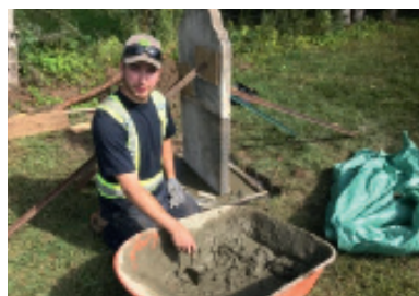
Spécialiste en patrimoine en train de construire une base pour un monument funéraire. Environ une vingtaine de pierres tombales ont été redressées depuis 2022. Source : Réseau canadien pour la préservation de la migration irlandaise
