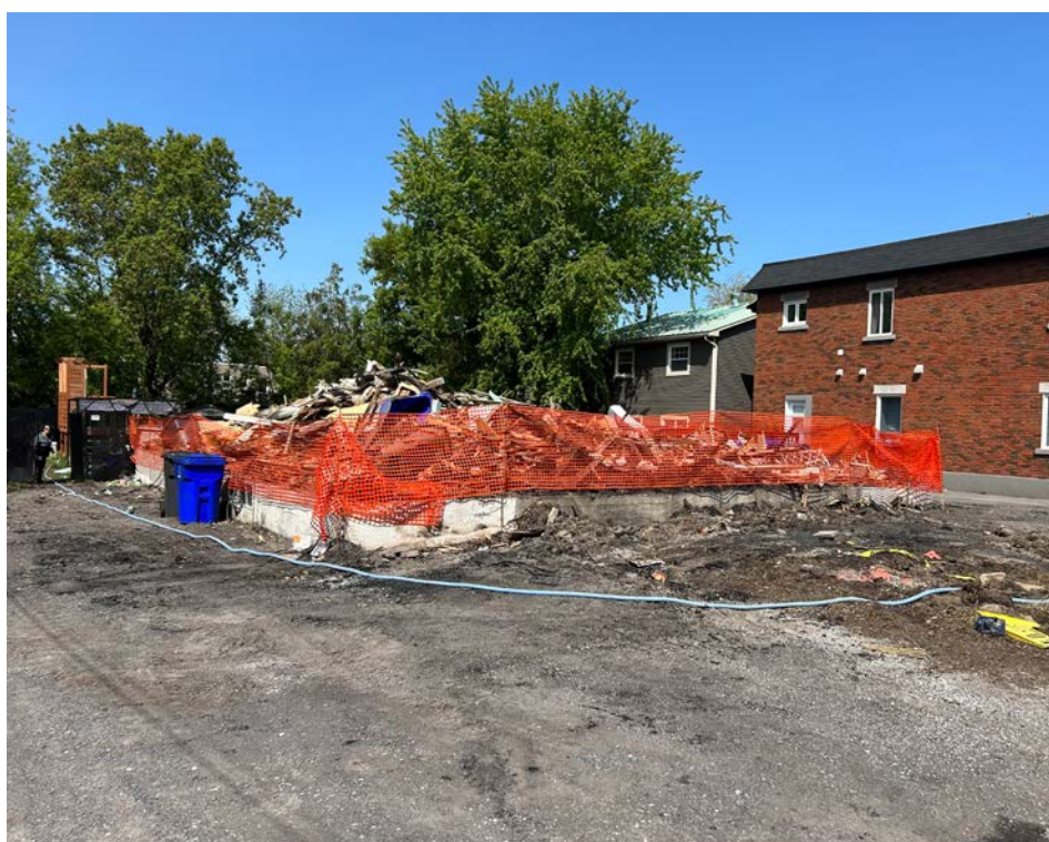
Il ne reste plus grand-chose de l'immeuble, démolé jusqu'aux fondations. (Photo : Julien Dubois)
