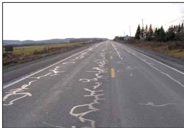
Mauvaises pratiques : scellement de fissures excessif en pistes de roues
