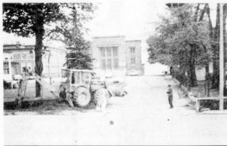
Cette photo, prise du pont de Ste-Marie, nous montre l'entrée qui mène au Centre Récréatif. Comme plusieurs l'ont déjà constaté, il n'était pas très facile d'emprunter la rue Notre-Dame, en sortant de cette rue. Les travaux en cours consistent à élargir la sortie de la rue, afin de faciliter la circulation.
