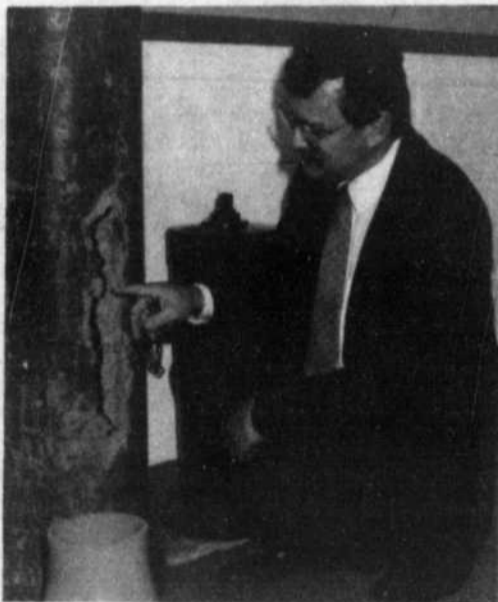
Pour un article paru le 27 mai 1990 dans L'Oeil Régional, M. Pierre Bélanger, directeur général de l'AIBR, avait montré l'effet de la corrosion sur un tuyau de fonte. Au bas de la photo, on aperçoit un échantillon de tuyau de PVC. C'est ce type de tuyau qu'on utilise maintenant à l'AIBR pour le remplacement de conduites corrodées.
