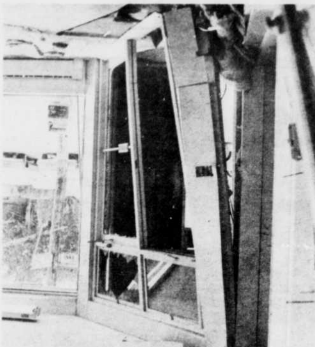
Vitrine fracassée — Une voiture est allée fracasser la vitrine du magasin Sherwin Williams situé sur la rue Sainte-Anne à Chicoutimi aux petites heures hier matin. Plusieurs milliers de dollars de dommages ont été causés à la façade du magasin.
