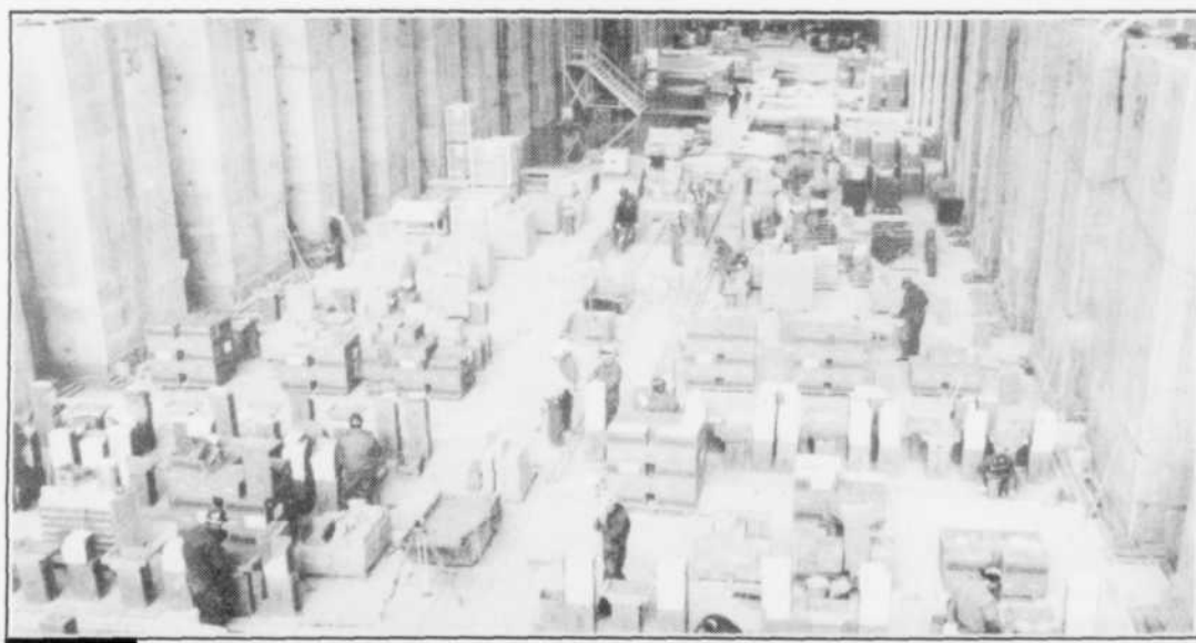
Cette autre vue d'ensemble nous permet de réaliser la profondeur (7,6 mètres) du four et de constater que les travaux en cours sont actuellement concentrés au fond du four.
