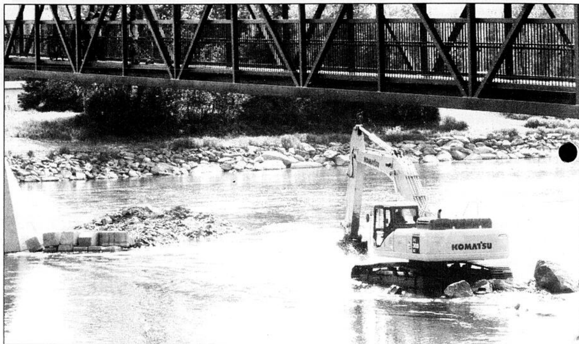
Les travaux de réparation de la structure du barrage gonflable vont bon train. (PHOTO: Jean -François Fecteau).
