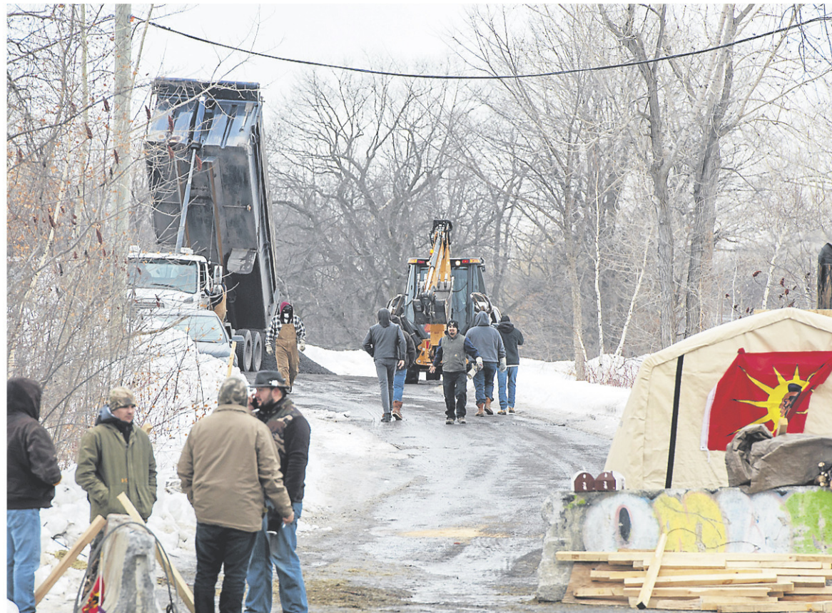
Sur le terrain mercredi, les Mohawks ont réagi à l'émission de l'injonction en renforçant le périmètre de la barricade par l'installation de murets de béton et le déversement de chargements de pierre. — PHOTO LA PRESSE CANADIENNE, RYAN REMIORZ
