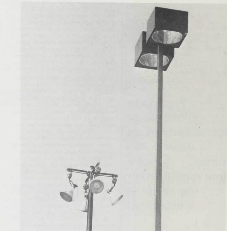
Le nouveau système d'éclairage du centre d'achats Fairmount Fair, fait usage de 14 poteaux de 50 pieds de hauteur utilisant deux lampes halogènes métallisées de 1,000 watts reconnues pour bien rendre la couleur des objets, pour leur longue durée et leur grande efficacité. A l'arrière on voit un vestige du vieux système d'éclairage.
