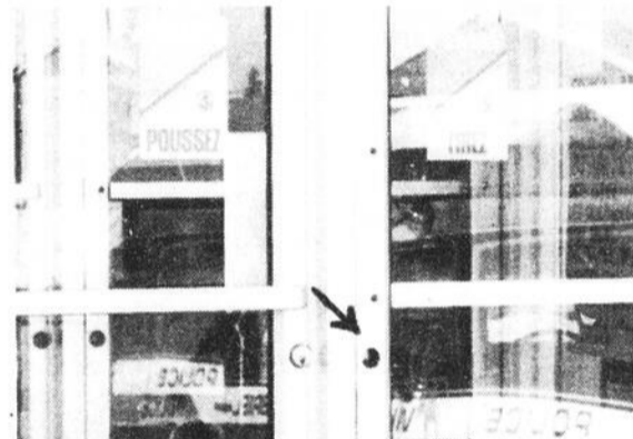
Au IGA, les voleurs ont démonté le barillet de la serrure de la porte, tel que l'indique la flèche.
