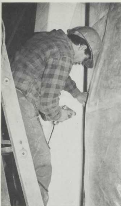
Pose de panneaux d'acier de revêtement mural dans une école de la région de Toronto.
