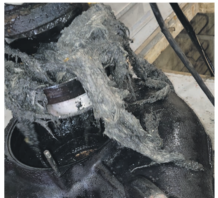
Les lingettes jetables, lorsqu'elles sont jetées dans les toilettes, obstruent et endommagent les systèmes de pompage. Photo courtoisie
