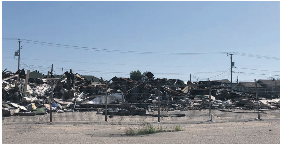
Le bâtiment qui abritait le restaurant Le Forum à Port-Cartier est une perte totale depuis l'incendie du 6 novembre. Photo Sylvain Turcotte
