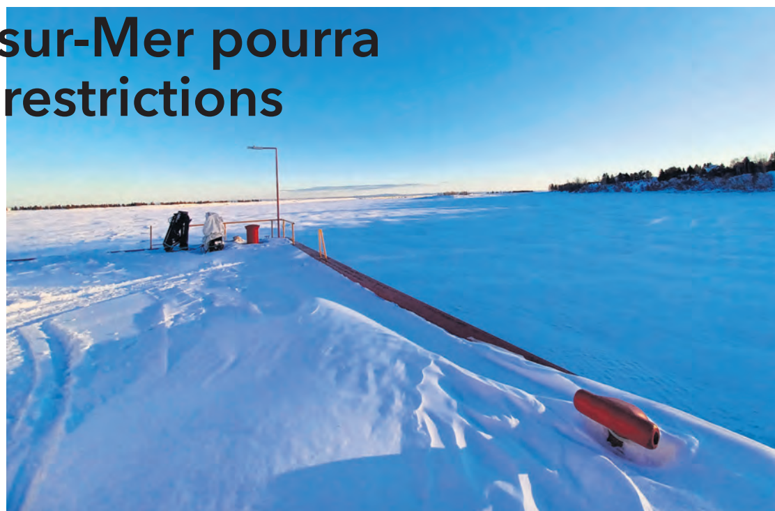
Le quai de Portneuf-sur-Mer pourra être utilisé malgré son état de décrépitude. Photo archives
