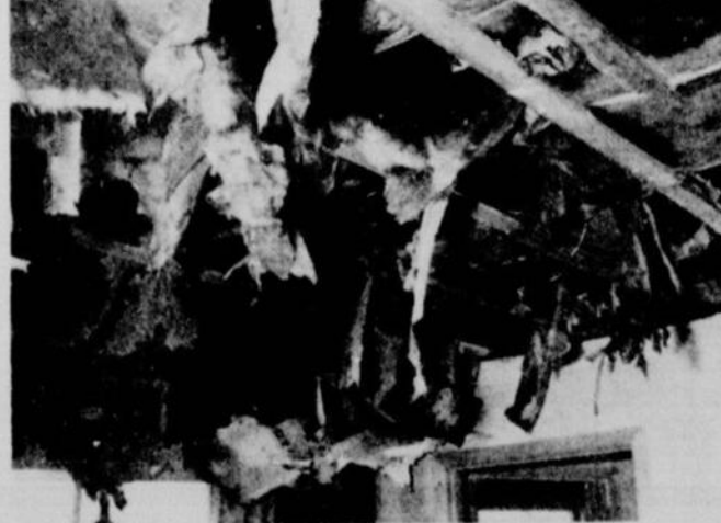
Cette fois, le pyromane a réussi: cette maison (photo du haut) devra être démolie complètement. En y regardant de plus près, on voit que le maniaque a fort probablement jeté de l'essence sur les murs extérieurs pour y mettre le feu (photo du centre). L'état du plafond du salon (photo du bas) reflète l'état dans lequel est la maison incendiée.
