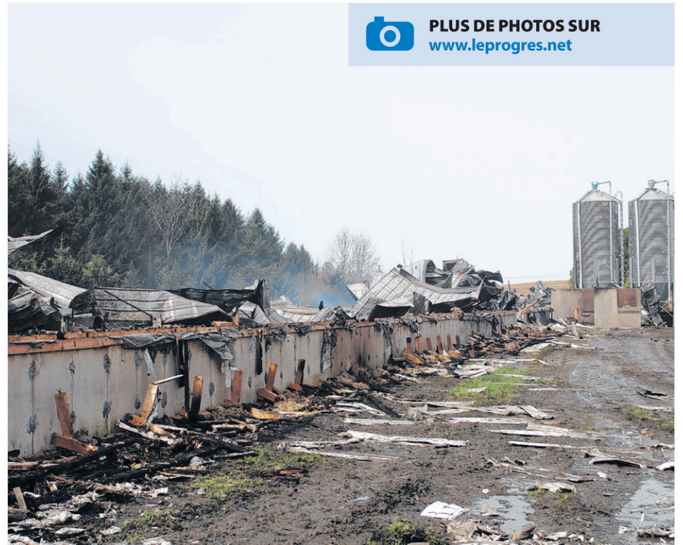
Un incendie a complètement rasé l'un des bâtiments de la ferme porcine MV.
