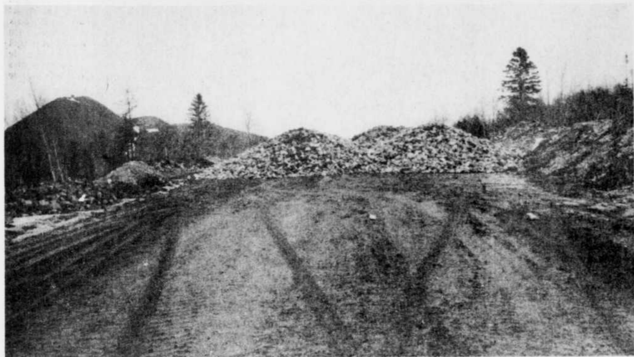
Une section de la route reliant les mines King-Beaver et B.C. demeure toujours fermée puisque
