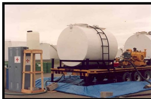
Figure 2.1 Citerne mobile dans un aménagement de rétention
