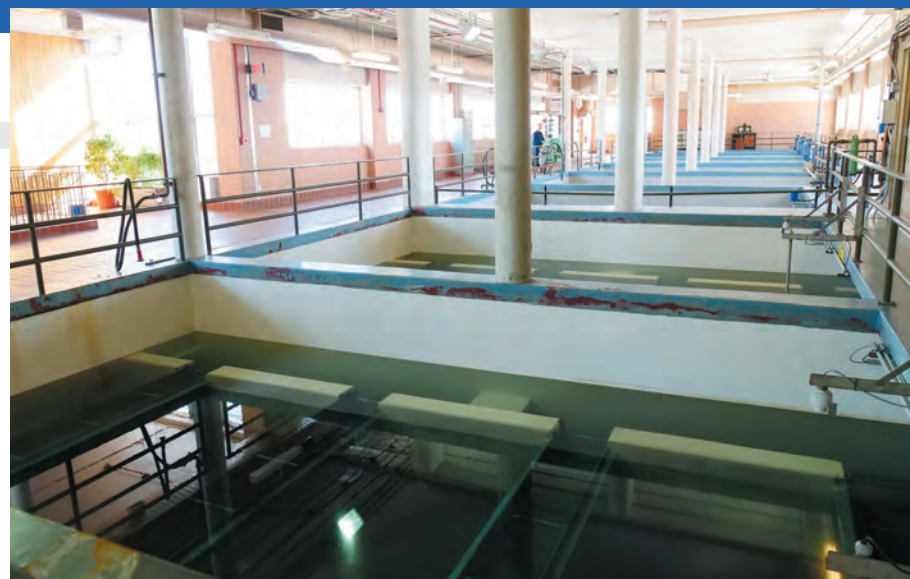
La salle des bassins à l'intérieur de la station de production d'eau potable.
