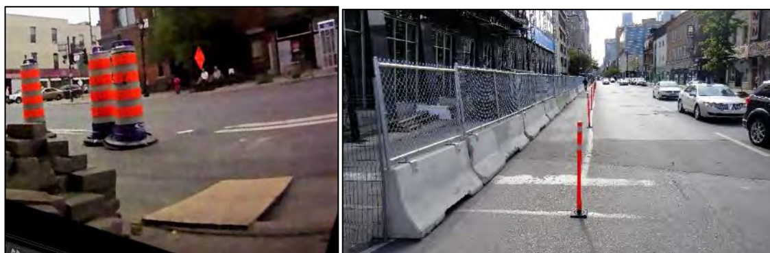
Figure 19 Chantier inapte (à gauche) et bien conçu (à droite) pour la circulation des AMM
