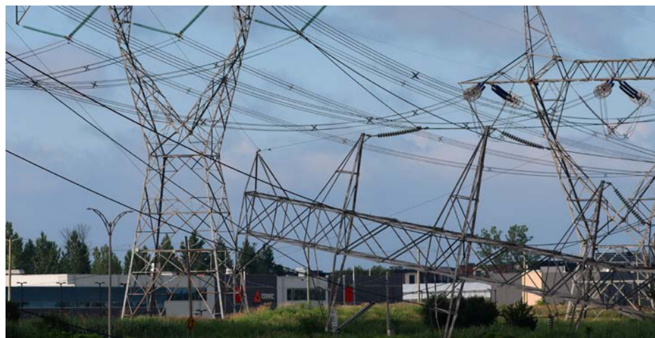
L'accident a provoqué une panne de courant majeure touchant près de 90 000 clients d'Hydro-Québec. (Photo : courtoisie - Sonia Colameo)
