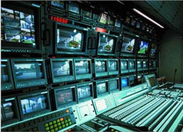
Salle de contrôle d'un studio de télévision
