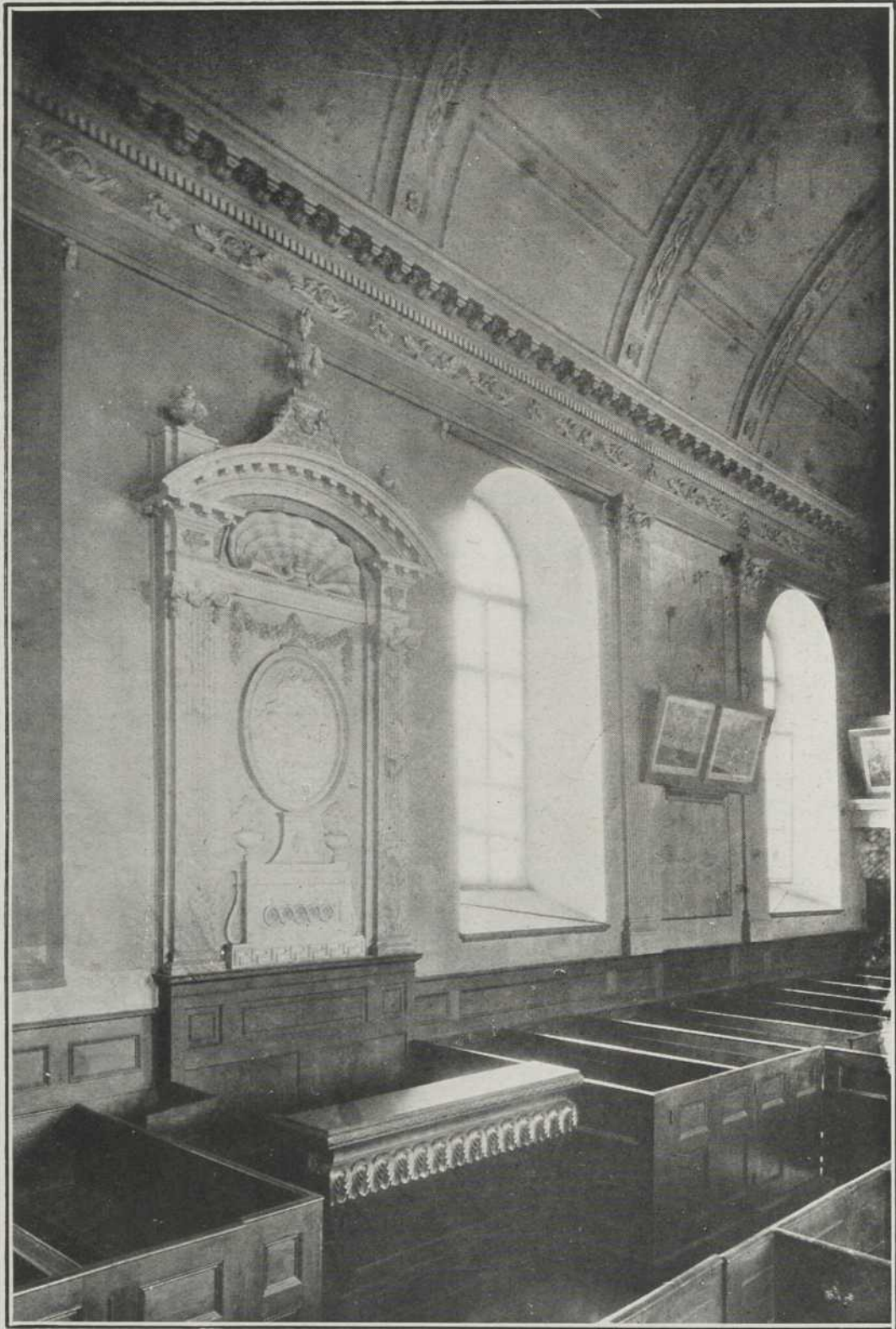
ÉGLISE DE SAINT-FRANÇOIS DE L'ÎLE D'ORLÉANS: MUR INCLINÉ À L'INTÉRIEUR
