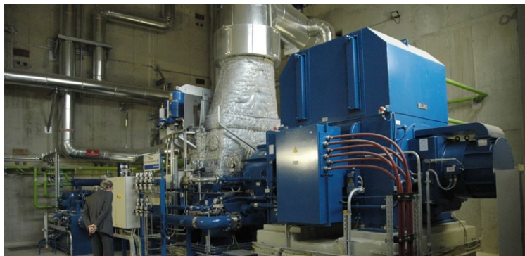
Turbine à vapeur à biomasse.
