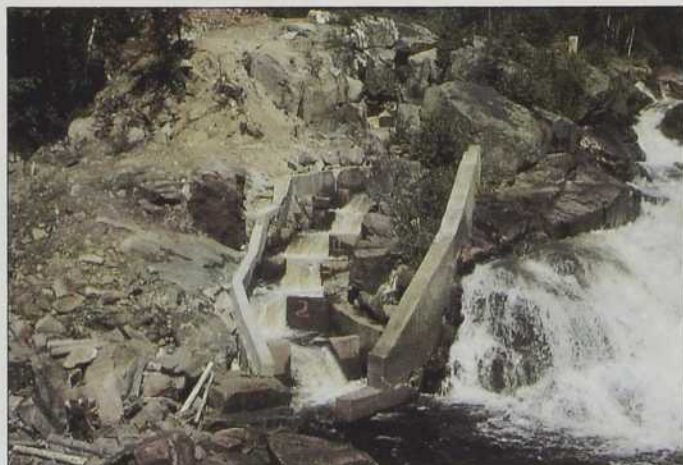
Si les grands Saumons montent par les échelles de montaison, les saumoneaux, eux, redescendent trop souvent par les turbines.
