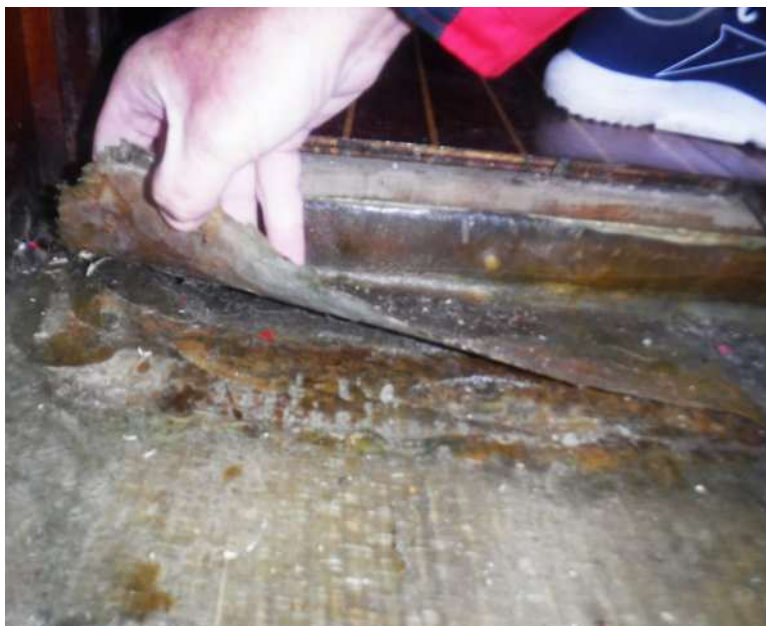
Renfort décollé par humidité et probablement gel et dégel.
