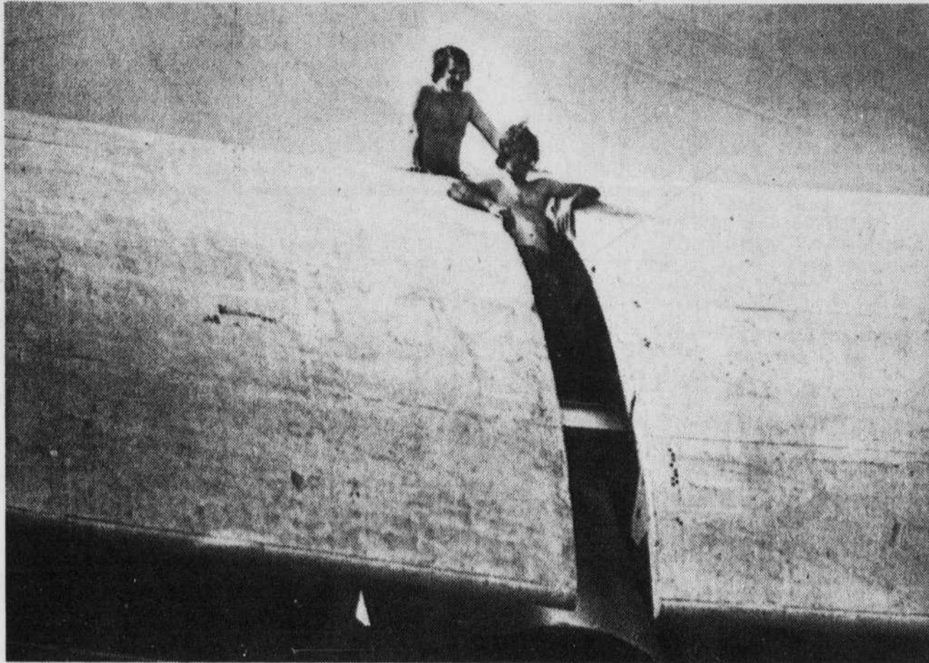
Perchés à presque 200 pieds au-dessus du sol, dans l'anneau technique du stade olympique, deux travailleurs du chantier ont profité de leur heure de déjeuner, hier, pour bénéficier des rayons du soleil et de la vue magistrale sur les installations. (Photo CP)
