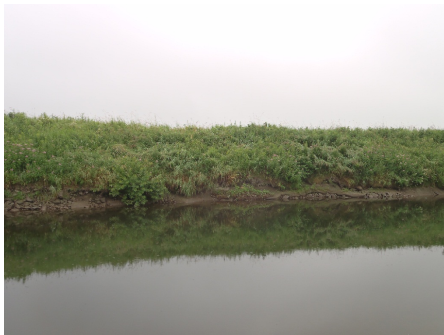
Photo 5 : Rive gauche de la Bulstrode au PK 14 (rive de priorité 3). Rive concave où l'ouvrage de protection se dégrade. Le déchaussement de la végétation observé au-dessus de l'ouvrage laisse croire que l'érosion reprendra à court terme dans la partie supérieure de la rive.
