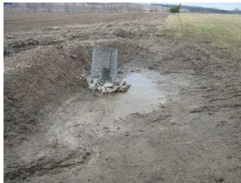
Figure 6 : Avaloir avec bassin de sédimentation.
