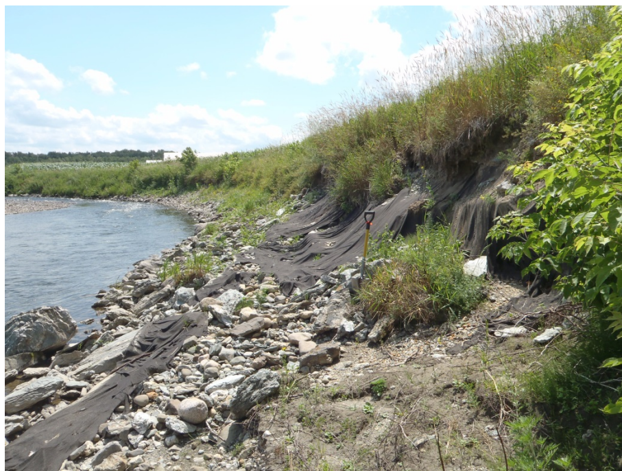
Photo 6 : Rive gauche au PK 20,9 (Priorité 3). Cette rive est soumise à l'attaque de forts courants. L'ouvrage en place devra y être amélioré puis revégétalisé.
