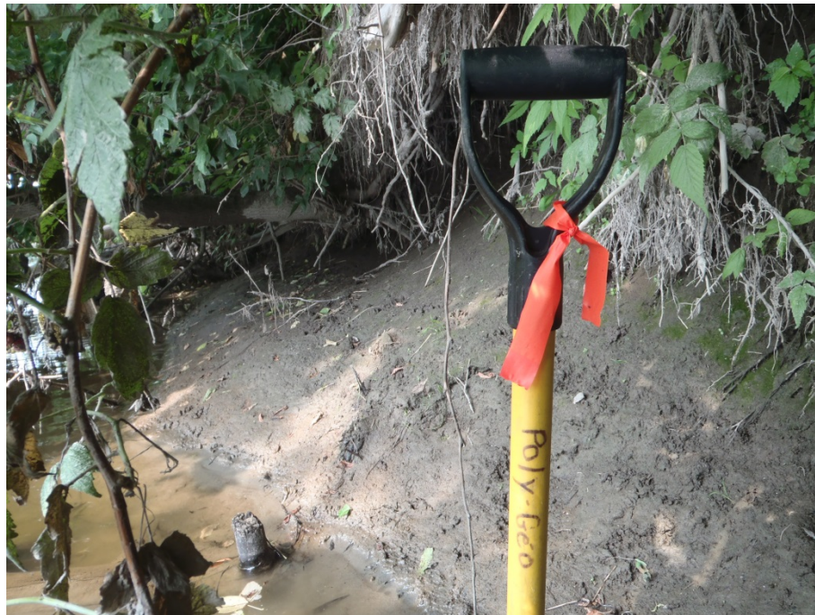
Photo 7 : Rive gauche au PK 11,5 (Priorité 4). L'action des courants à la base de cette rive a entraîné le sapement des sols sous le couvert végétal. L'érosion y évolue lentement et des travaux de revégétalisation y sont recommandés.
