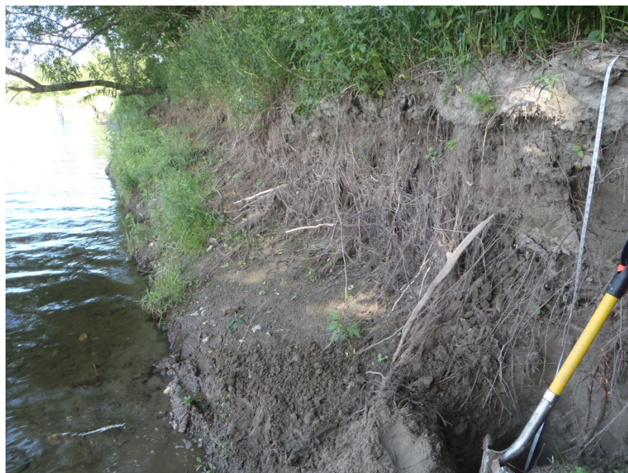
Photo 8 : Rive gauche au PK 19,7 (Priorité 4). Bien que l'érosion y soit assez nette, cette rive a subi un faible recul depuis 50 ans. Des travaux de revégétalisation (ensemencement et plantation) pourraient augmenter sa résistance aux agents d'érosion.
