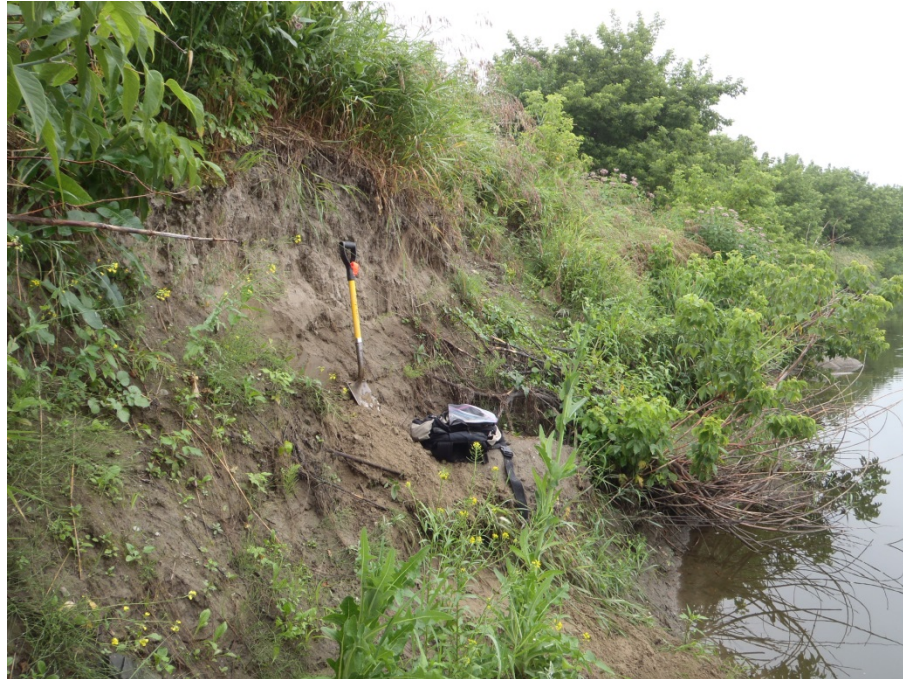
Photo 3 : Rive gauche au PK 14,6. Rive concave de priorité 2 où l'on recommande une stabilisation à l'aide de techniques mixtes.
